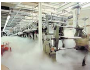
Printing Press LP CO2 Discharge.jpg
